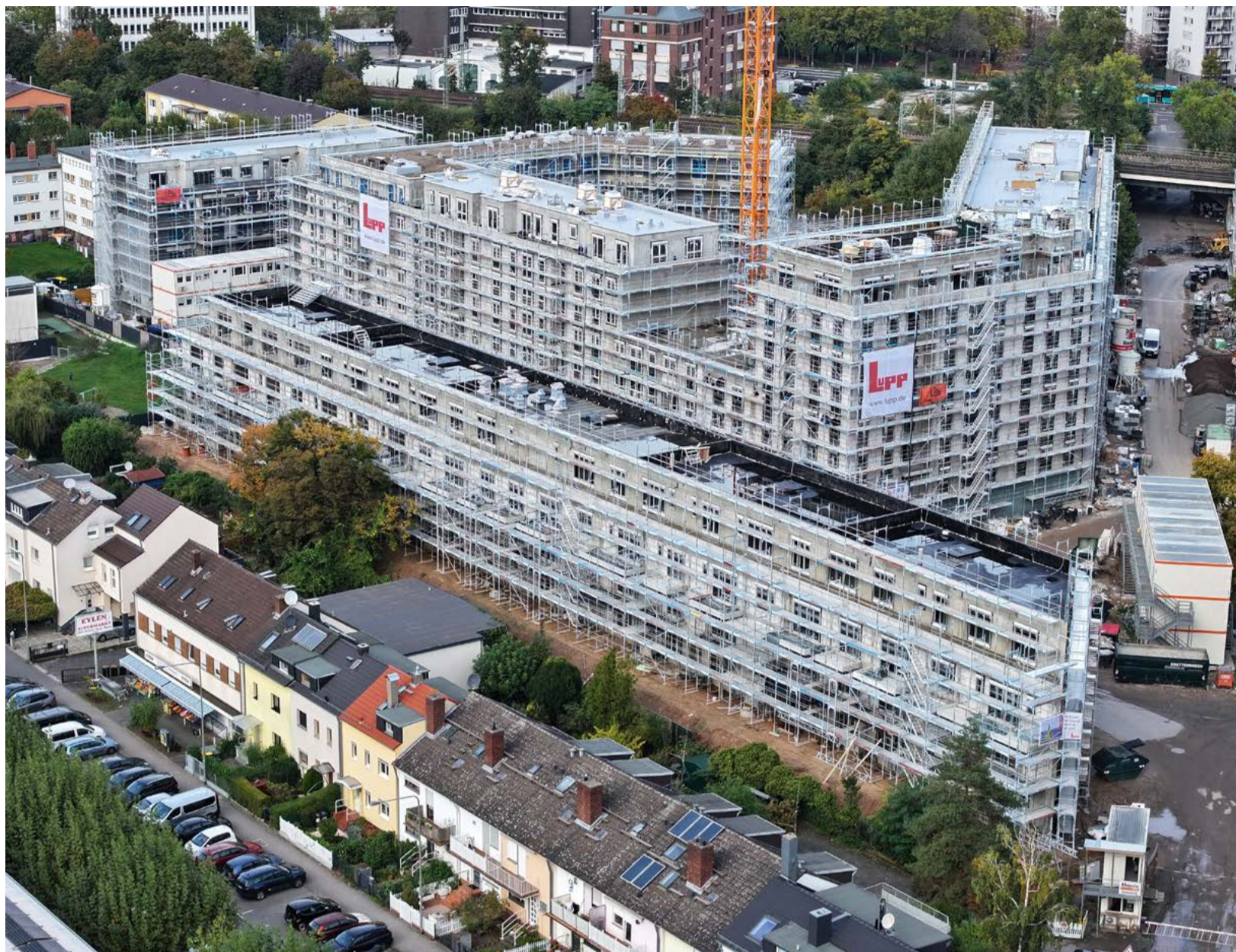
Ende August 2024 hat Lupp damit begonnen, den Ausbau, die Gebäudehülle, die Haustechnik sowie die Außenanlage von Westville, dem neuen Quartier im Frankfurter Gallus, umzusetzen. Die an die Arge Lupp/Streib beauftragten Abschnitte sollen bis Ende 2025 an den Bauherrn übergeben werden.
