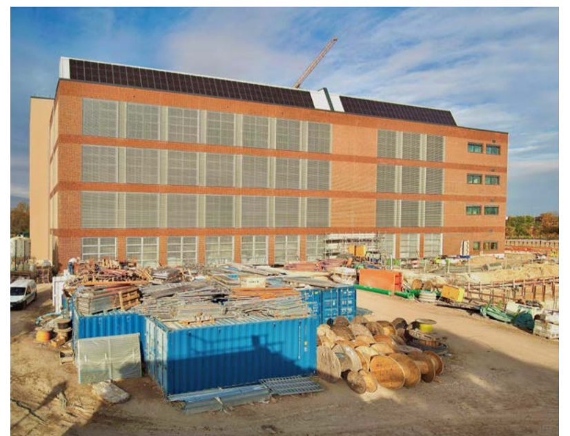
Das neue Rechenzentrum BERO1 ist leistungsstark und nachhaltig und setzt damit ein Zeichen in Richtung zukunftsweisende Datacenter. Nach der Fertigstellung bietet es auf vier Vollgeschossen sowie einem Untergeschoss insgesamt 5.100 Quadratmeter hoch gesicherte IT-Fläche.
