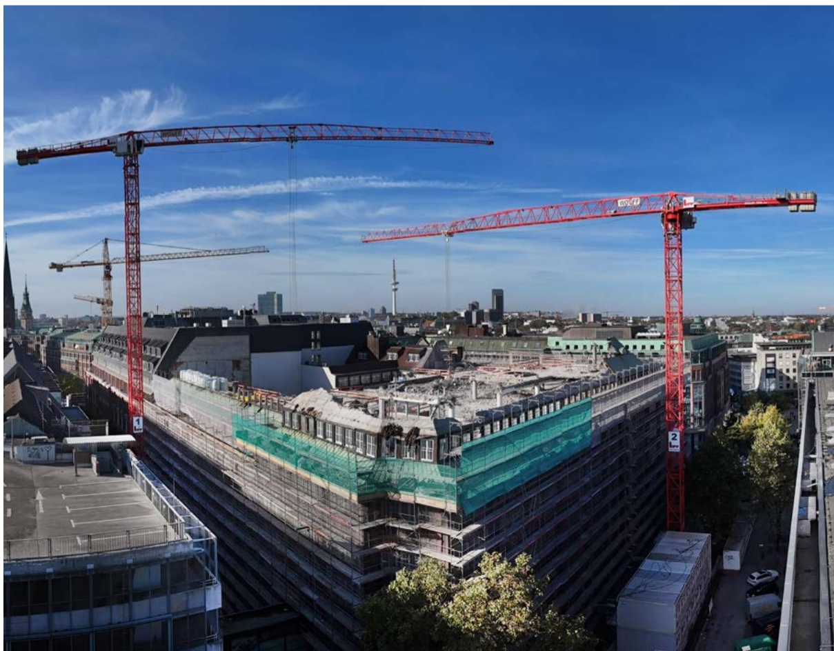
Viel mehr als rohe Kräfte ist beim Revitalisierungsprojekt Klöpperhaus echtes Fingerspitzengefühl gefragt: Die beiden vorhandenen zwei Dachgeschosse werden vorsichtig abgebrochen, um Platz für die drei neuen Dachgeschosse zu schaffen.
